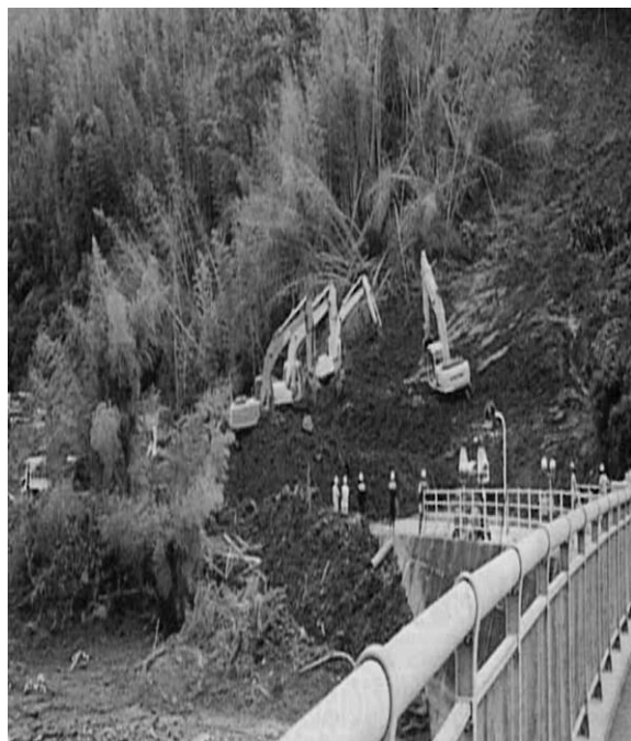
平成 18 年 6 月県道給島櫛浜停車場線 土砂崩落
